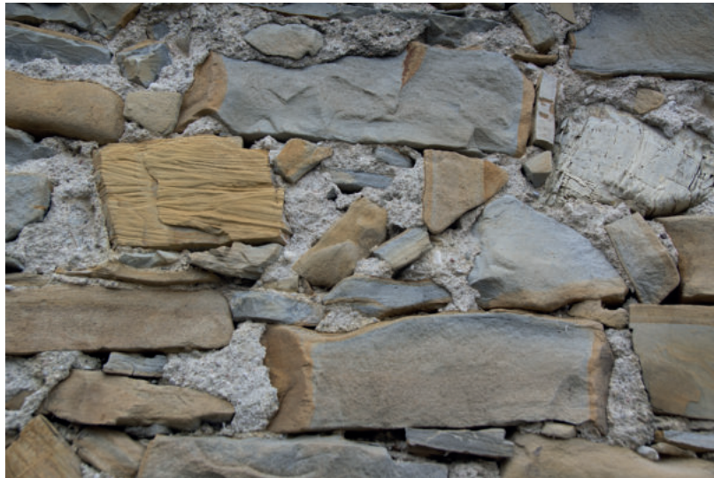
Abb. 1. Bruchsteinmauerwerk an einer Stallung in Ulrichshögl mit grauen Sandsteinblöcken, die randlich die bräunlichen Verwitterungskrusten zeigen. Ähnliche Beobachtungen können auch an den Fundstücken aus der Grabung in der ehemaligen Kirche auf der Herreninsel gemacht werden.
