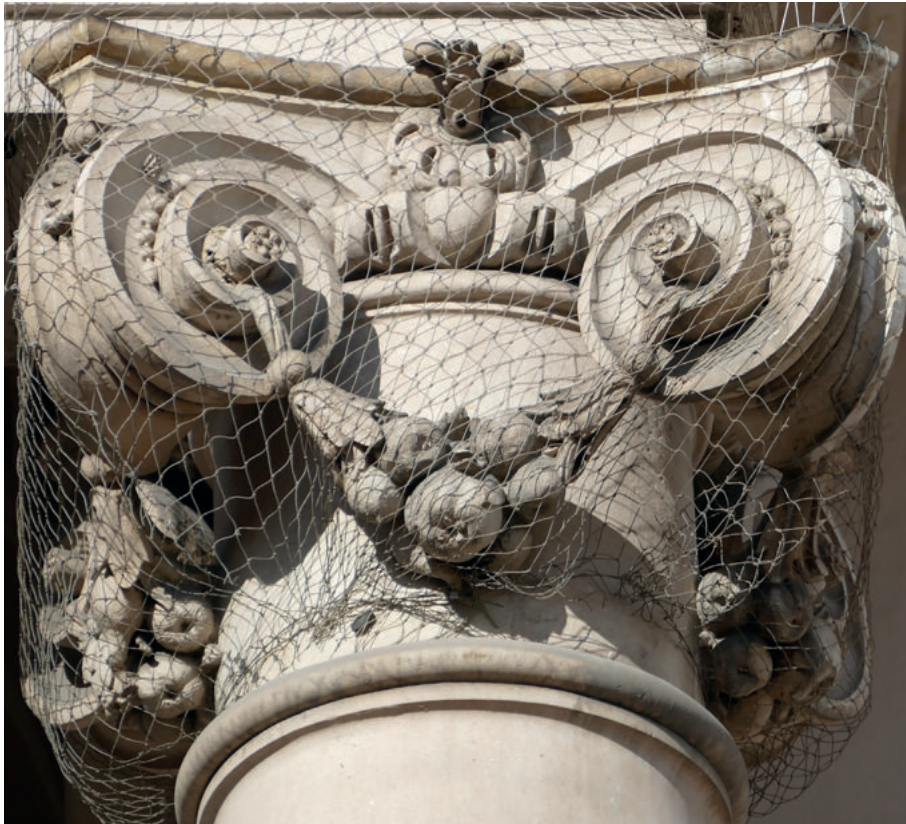
Abb. 28. Bei der Neuerrichtung der St. Erhard-Kirche in Salzburg in den Jahren 1685–89 wurden viele Werkstücke aus Högl Sandstein verwendet. So bestehen die Kapitelle der Portikus-Säulen aus dem „Salzburger Sandstein“. – Foto G. Spaun, Salzburg.
