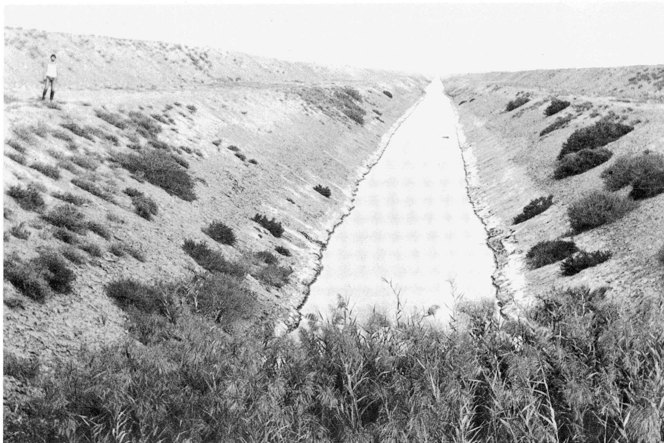
1 Entwässerungskanal des Hillāh-Diwaniyāh-Projektes: Main Drain IV am Übergang bei km 37,22. Blickrichtung nach Südost. Kanaltiefe bis zum Grundwasser: 5,50 m. Im unteren Drittel der Wände weiße Salzausblühung. Im obereren Drittel Grenze zwischen kapillar durchfeuchtetem (dunkel) und völlig ausgetrocknetem Boden (hell). Foto: 18. 10. 78.
